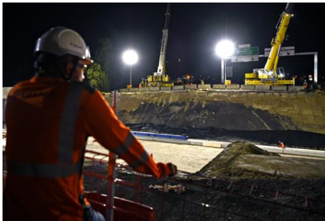
Sur le périphérique à hauteur de Saint-Fons, lors du chantier pour la nouvelle ligne de Tramway.
