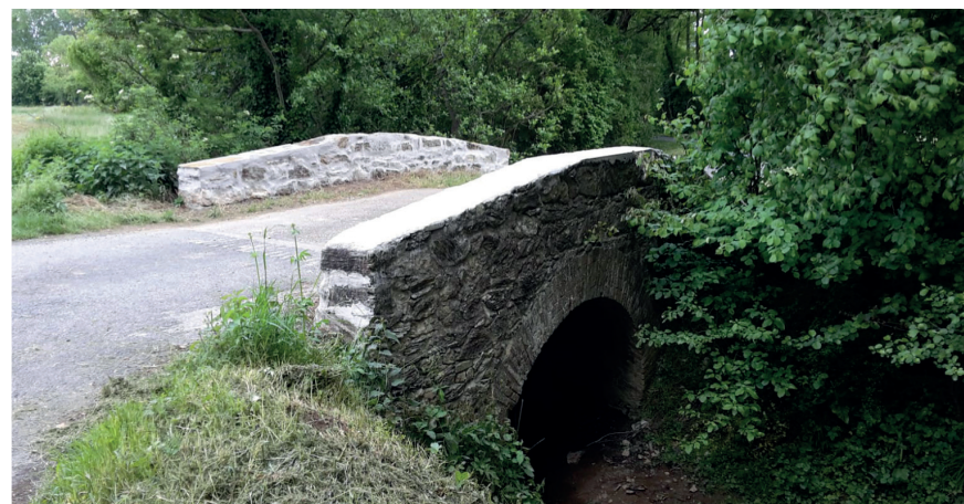
Réparation en beauté du petit pont de pierres
